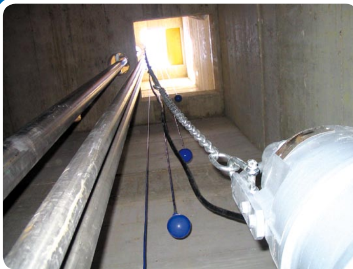
Foto 1 box 8 Pompe ad immersione Estrazione del percolato vista dal fondo interno.
