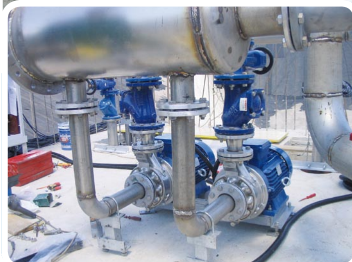
Foto 3 box 8 Pompe di rilancio del percolato estratto.
